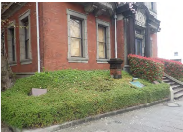
図23 改修前の外構。 門柱の大半は植栽に隠れてしまっていた。
